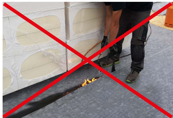
Abb. 19: Besonderes Gefahrenpotential bei Materiallager. Die Flamme kann durch die Sogwirkung unter das Material ziehen und dieses von unten entzünden.
