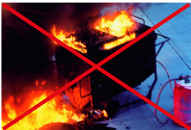
Abb. 22: Negatives Beispiel eines Bitumenofens, der in Brand geraten ist, ohne Überlaufwanne und ohne 3 m Sicherheitsabstand der Gasflasche.
