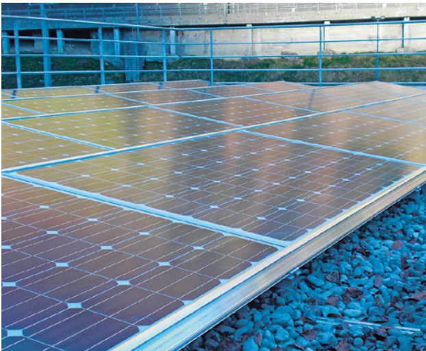
Bild 4 Solaranlage auf Flachdach mit umlaufendem permanentem Geländer
